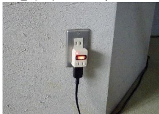
電源 (バルコニー)
